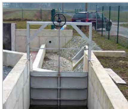
Канален шлюз с ръчно задвижване
